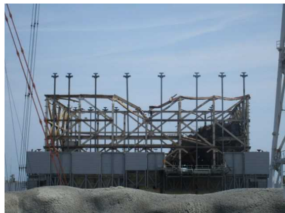
Ptcl.14 1号機建屋の状況
