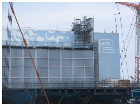
Ptcl.15 2号機建屋の状況
