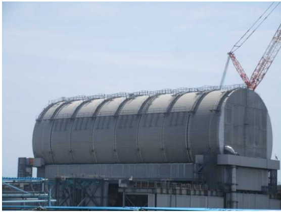
Ptcl.16 3号機建屋の状況
