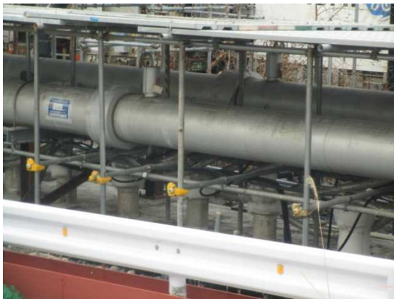
Ptcl.18 陸側遮水壁（凍土壁）設備
