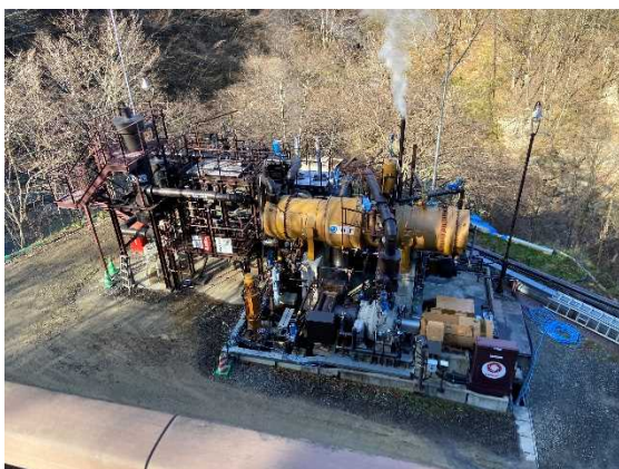
Ptcl.54 16号源泉バイナリー発電所
