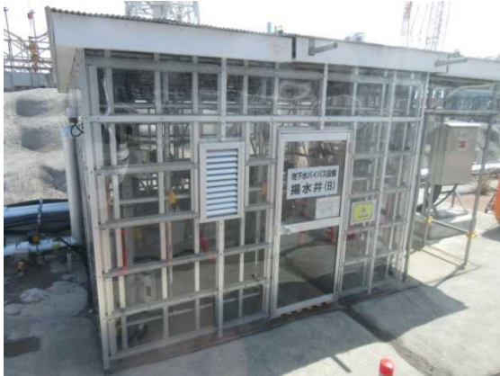
Ptcl.17 地下水バイパス設備
