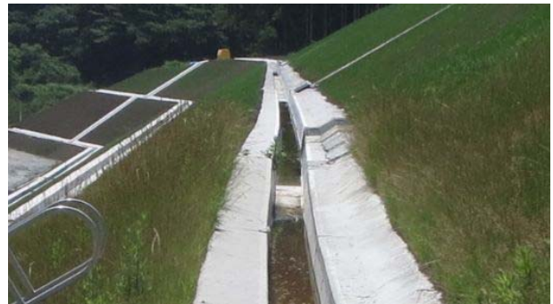
写真-4 小段水路の変形.手前(北側)が外側に屈曲
