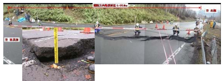
写真-1 路面亀裂の状況
