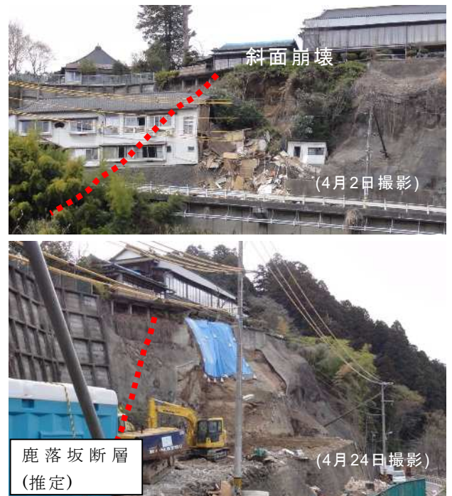
図 6 「鹿落坂断層」北方の斜面崩壊
