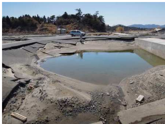
写真-3 津波による舗装面の浸食状況 (宮城県亶理郡山元町磯浜)
