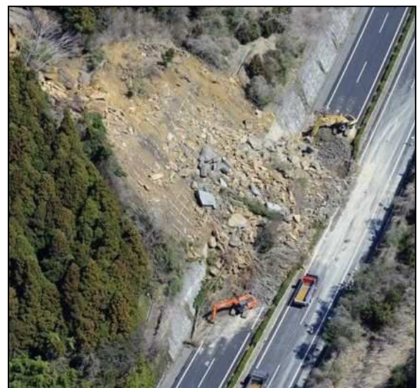
図-2 崩壊直後の状況
