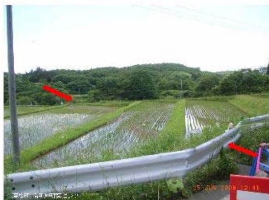
②同左地点のガードレールの折れ曲がりから東西の圧縮変形が読み取れる また水田にも北西側上がりの変形が認められる (産総研 活断層研究センター HPより)
