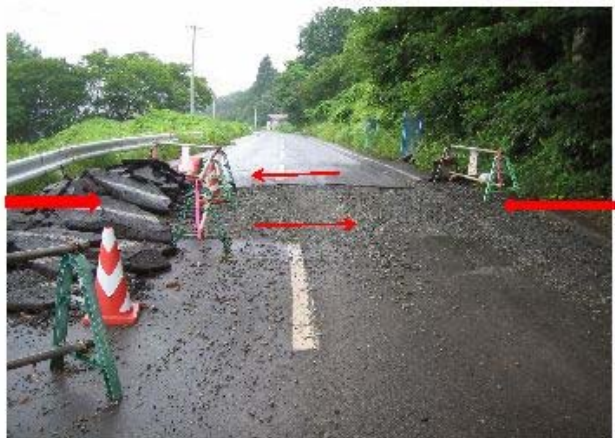
①国道49号に現れた地表地震断層 左横ずれを示し上下方向では西側上がりとなっている
