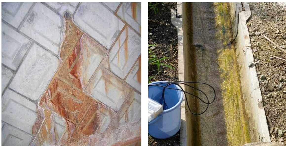
写真-4 浸出水によるセメント分の浸食（左）、用水路に発生した藻（右）
