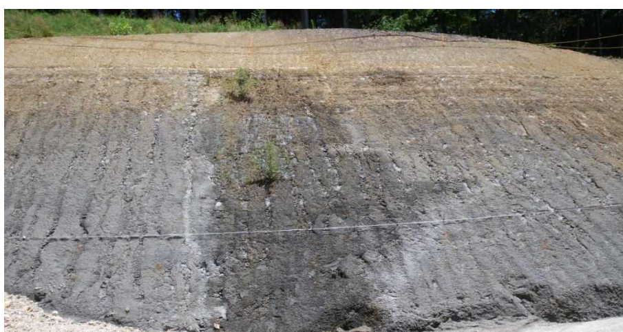
広島県での例。泥岩層の上位にある砂泥互層の一部が水みちになっている。
