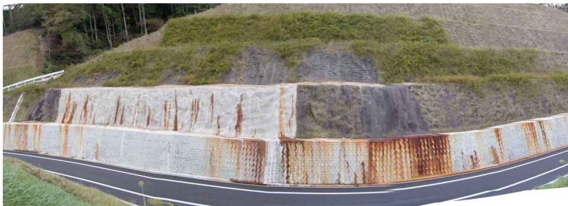
写真-3 切土の状況。浸出水は鉄分も含むのでさび色を呈する。植生工が一部枯死している。
