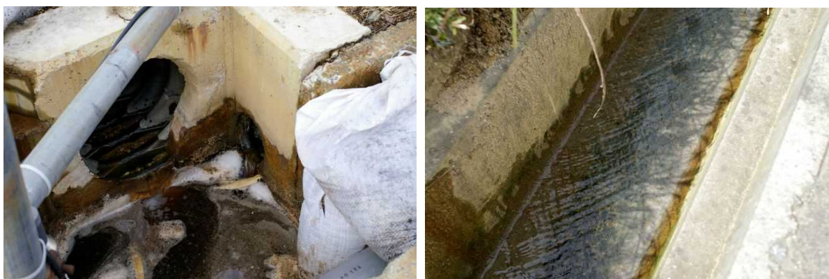
写真-5 残土置き場末端の pH3 未満の浸出水（左）、用水路底の白色沈殿物被膜（右）
