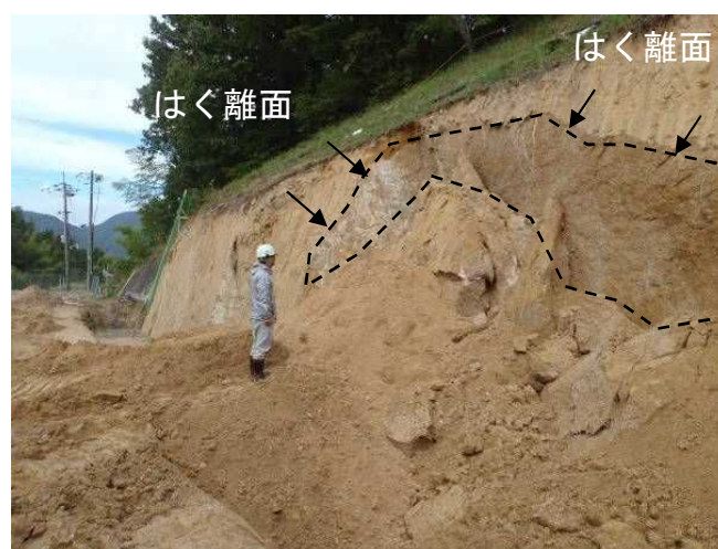
写真-3 粘土細脈をはく離面として崩壊が発生した事例
