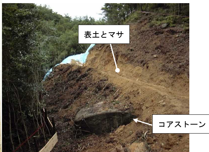
写真-5 掘削時に出現したコアストーン
