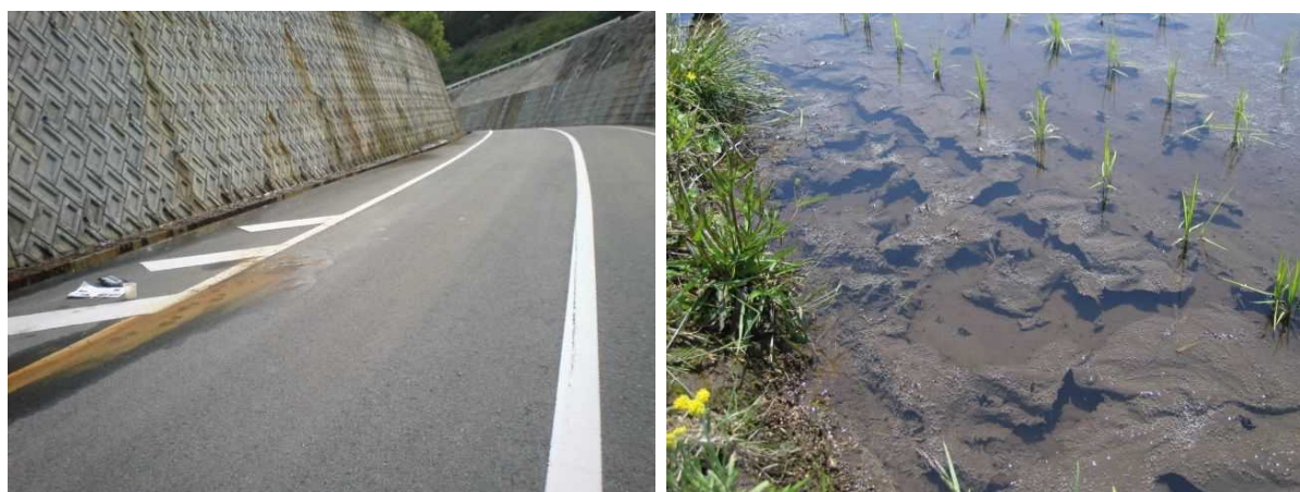
写真-6 酸性水による路盤劣化（左）、水田で増殖した好酸性細菌による表土はく離（右） 好酸性細菌の光合成で膜状の土が水面に浮き、錠剤の農薬散布が効かなくなっている
