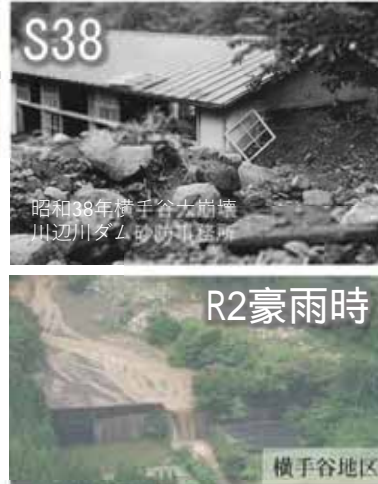
令和2年7月豪雨時 川辺川ダム砂防事務所
