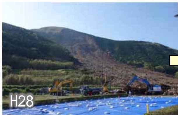
同地点の被災直後 (H28熊本地震) H28.4.22撮影
