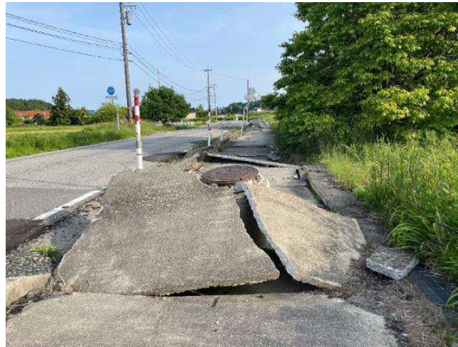
珠洲市 液状化による マンホール浮き上がり
