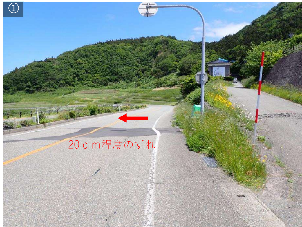
左側崖の右横ずれ亀裂（修復痕） （右側崖や中央部にも）
